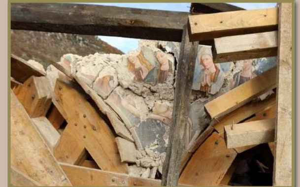
Resti della Scena della Deposizione dopo l'ultima scossa del 30 Ottobre 2016.
